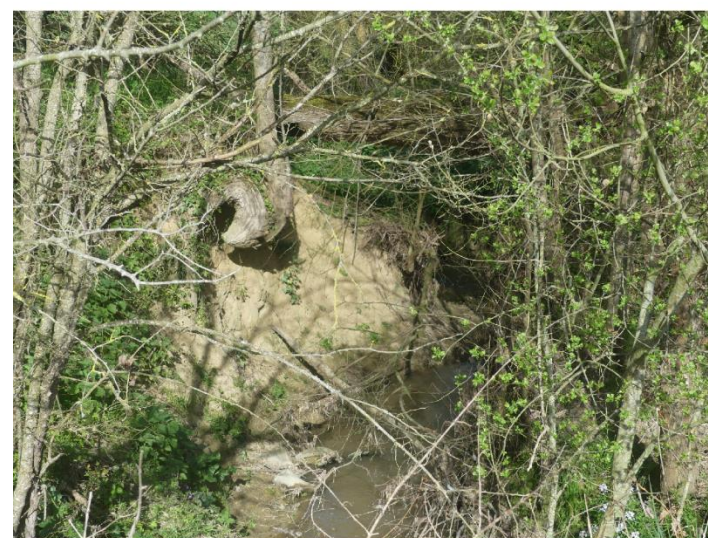
Erosion de berges du Girou (le Bousquet, Puylaurens)
